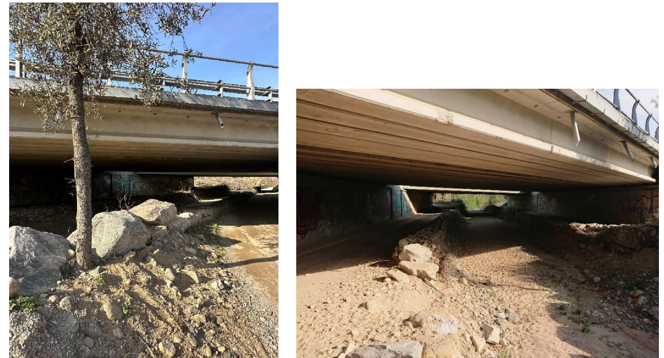
ACT 27 – Riera Fuirosos – Camí per al trànsit i en nivell inferior la riera
