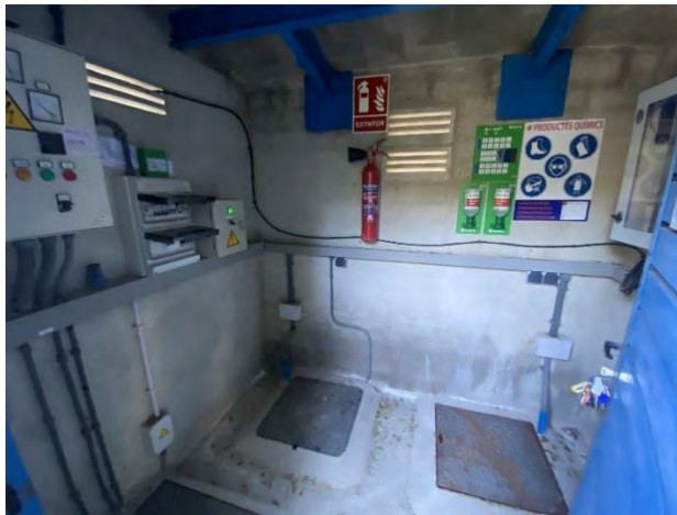
Figura 20 - Bombament elevació Cisterna Can Coll.
