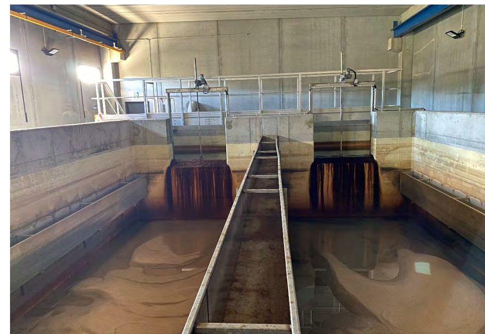
Figura 51. Cambres de filtració (filtres de sorra oberts).
