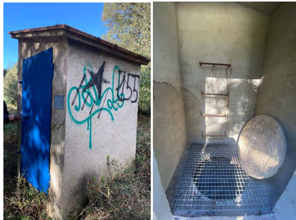
Figures 5 i 6. Exterior caseta de connexió mines (1), Interior caseta connexió (2).
