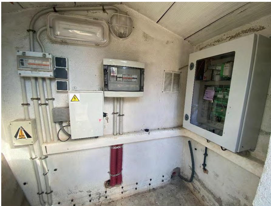
Figura 69. Quadre elèctric i telecontrol.
