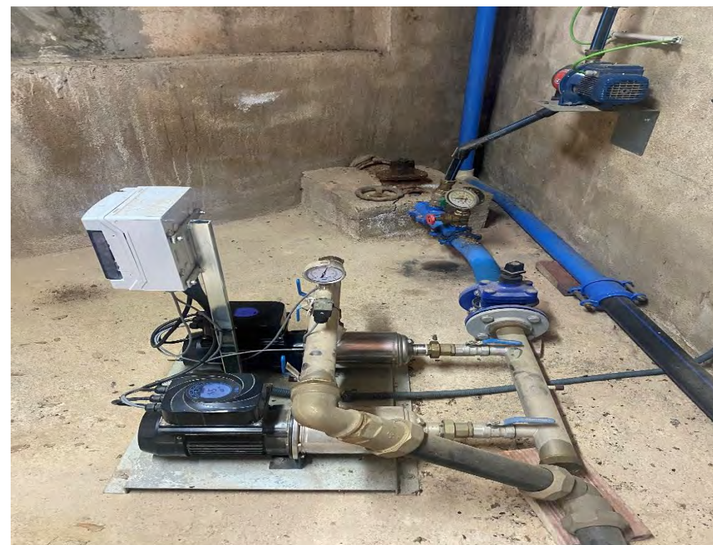
Figura 36. Grup de pressió dipòsit Cal Batlle 2.
