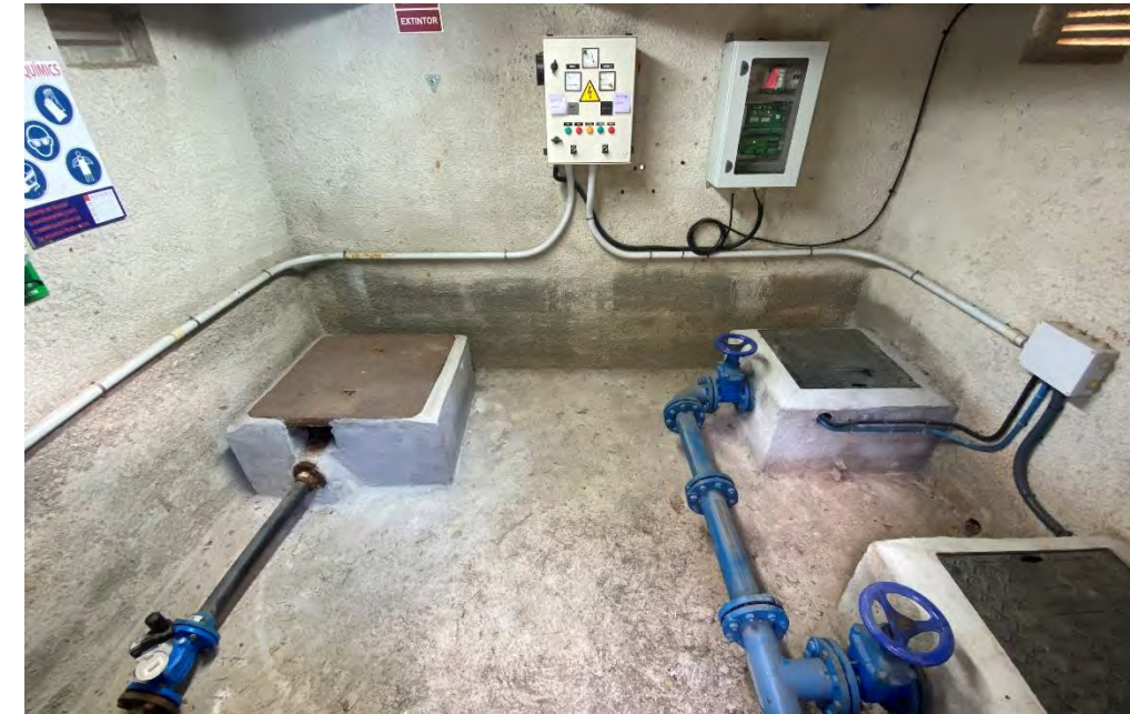
Figura 48. Interior caseta i PLC cisterna Boscos Montnegre.
