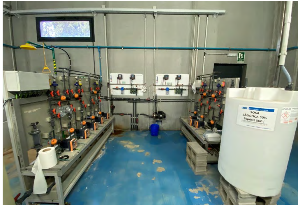
Figura 60. Sala dosificació reactius.
