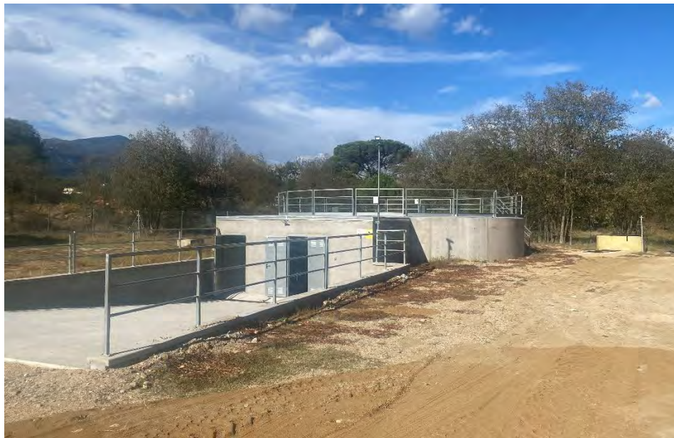
Figura 39. Dipòsit La Batlloria.
