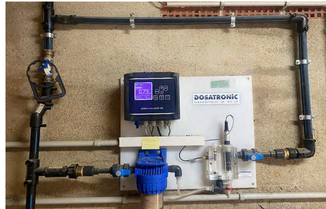
Figura 37. Autoanalitzador i clorador dipòsit Cal Batlle 2.
