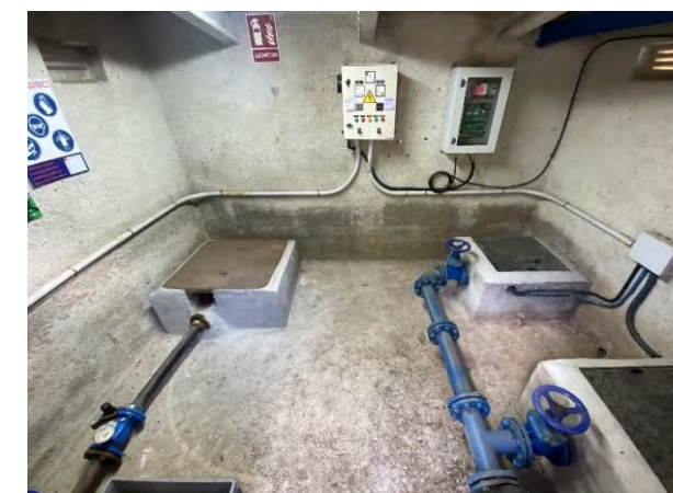
Figura 19 - Bombament elevació Cisterna Boscos.
