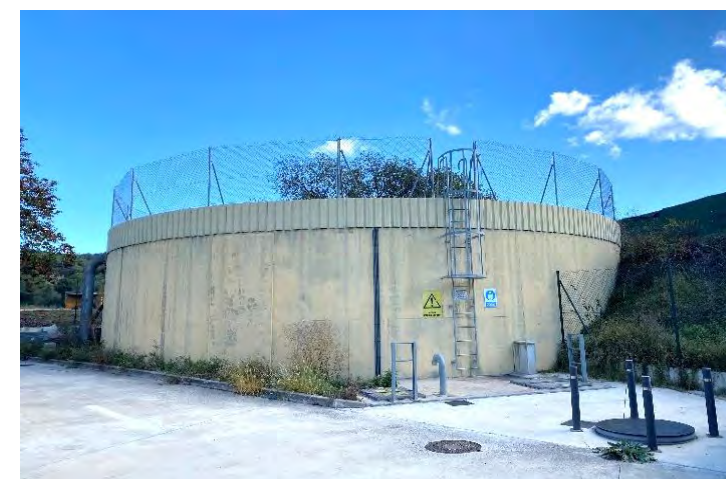
Figura 9 – Dipòsits de Can Sans.
