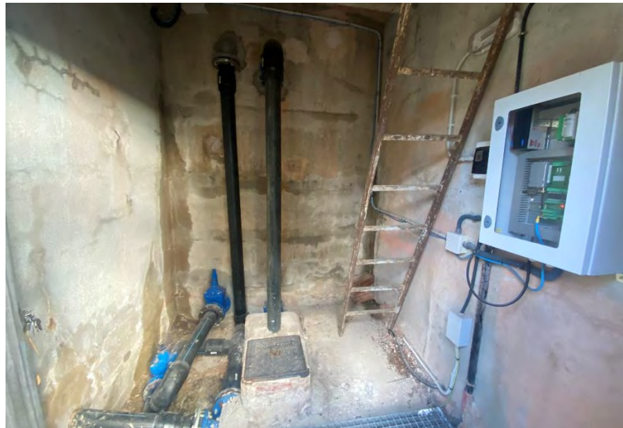
Figura 23. Interior caseta dipòsit Virgili.
