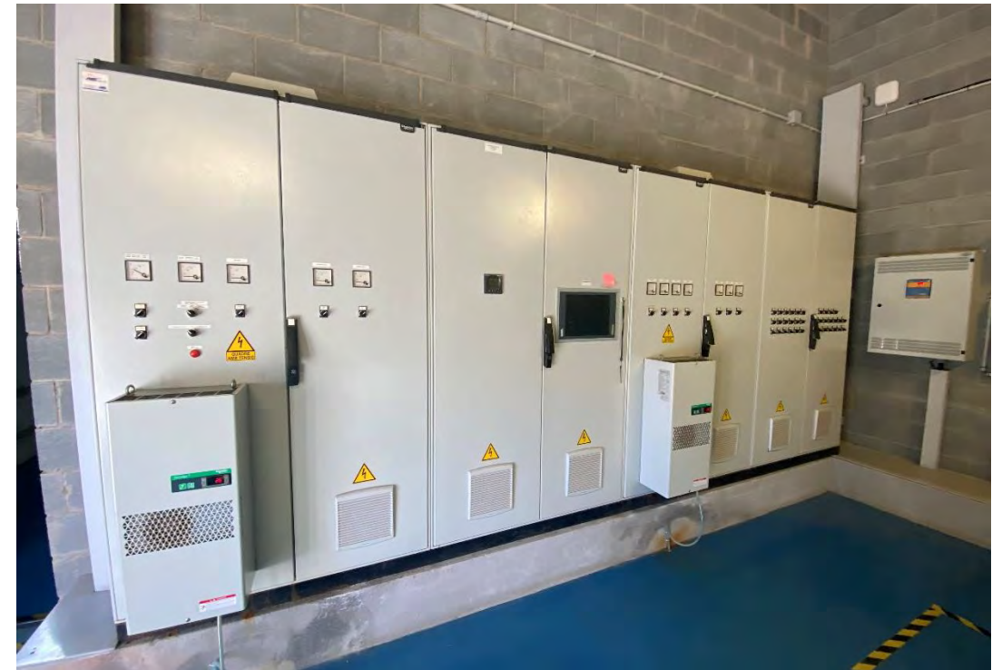
Figura 62. Armari quadres elèctrics i telecontrol.
