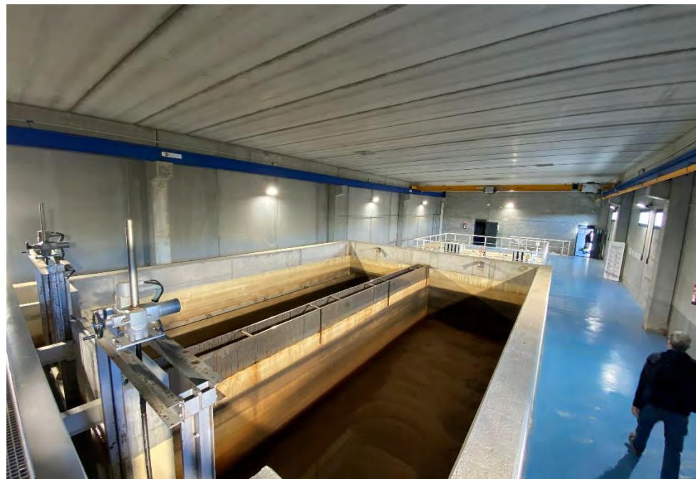
Figura 52. Cambres de filtració (filtres de sorra oberts).
