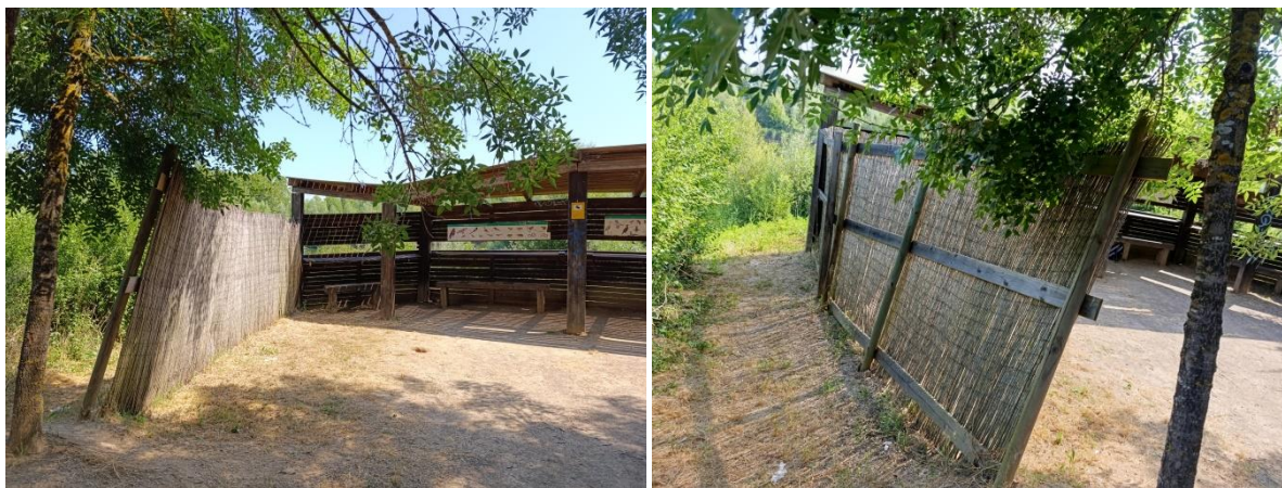
Estat actual del lateral del mirador
